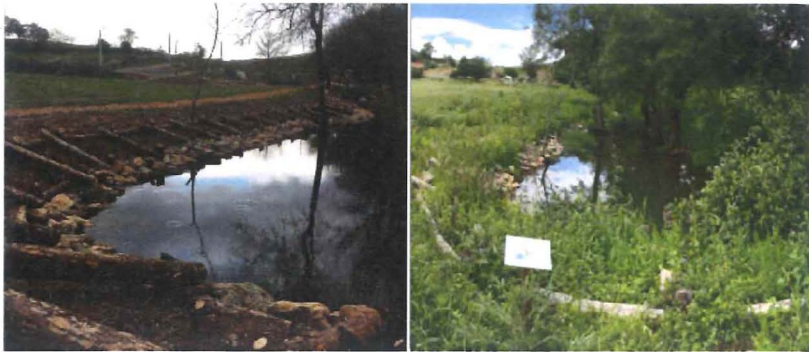
Figura 3: Labrios+ da ribeira do Juncal (Mogadouro) - esquerda: aplicação de grade viva; direita: evolução temporal do mesmo local
